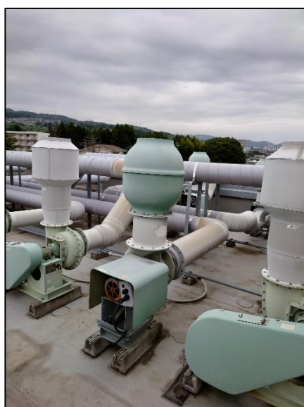
図1 屋上に設置された排風機
